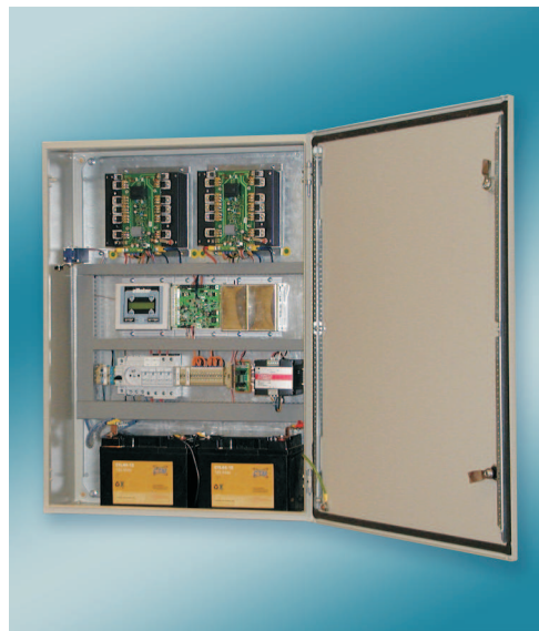
Obr.: Vnitřní uspořádání rozvaděče.
